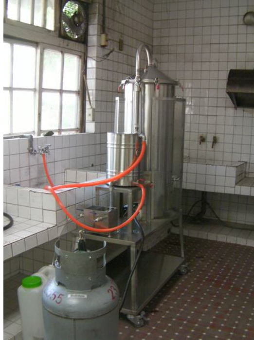
圖 3、不鏽鋼製之蒸餾加熱處理設備
